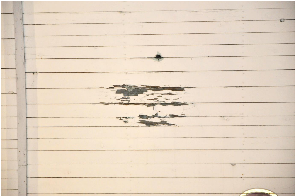
Fot. 15. Łuszcząca się i odpadająca polichromia ze sklepienia.
