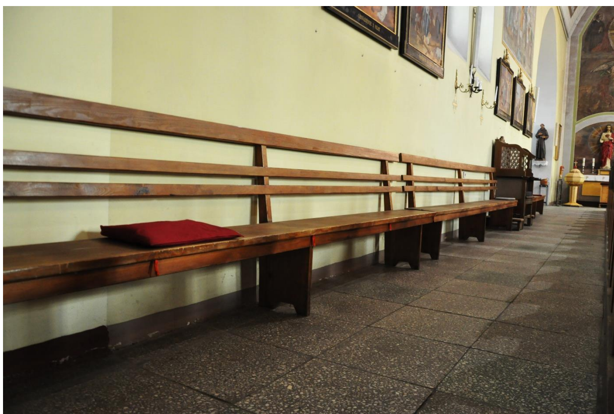
Fot. 20. Brudne z uszkodzeniami przyziemie ścian.
