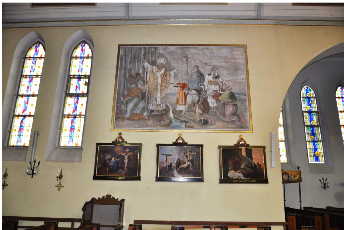
Fot. 19. Zakurzone i przybrudzone ściany.
