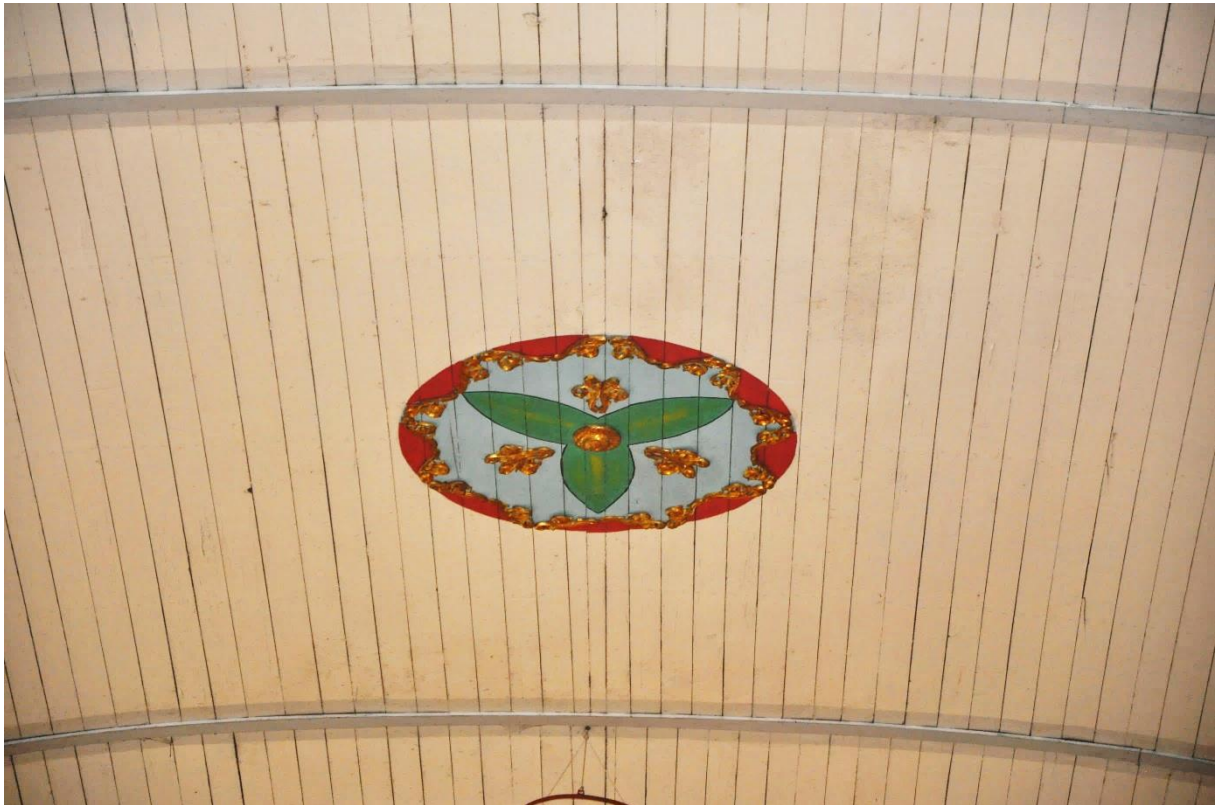
Fot. 17. Zakurzone i przybrudzone sklepienie nad nawą.
