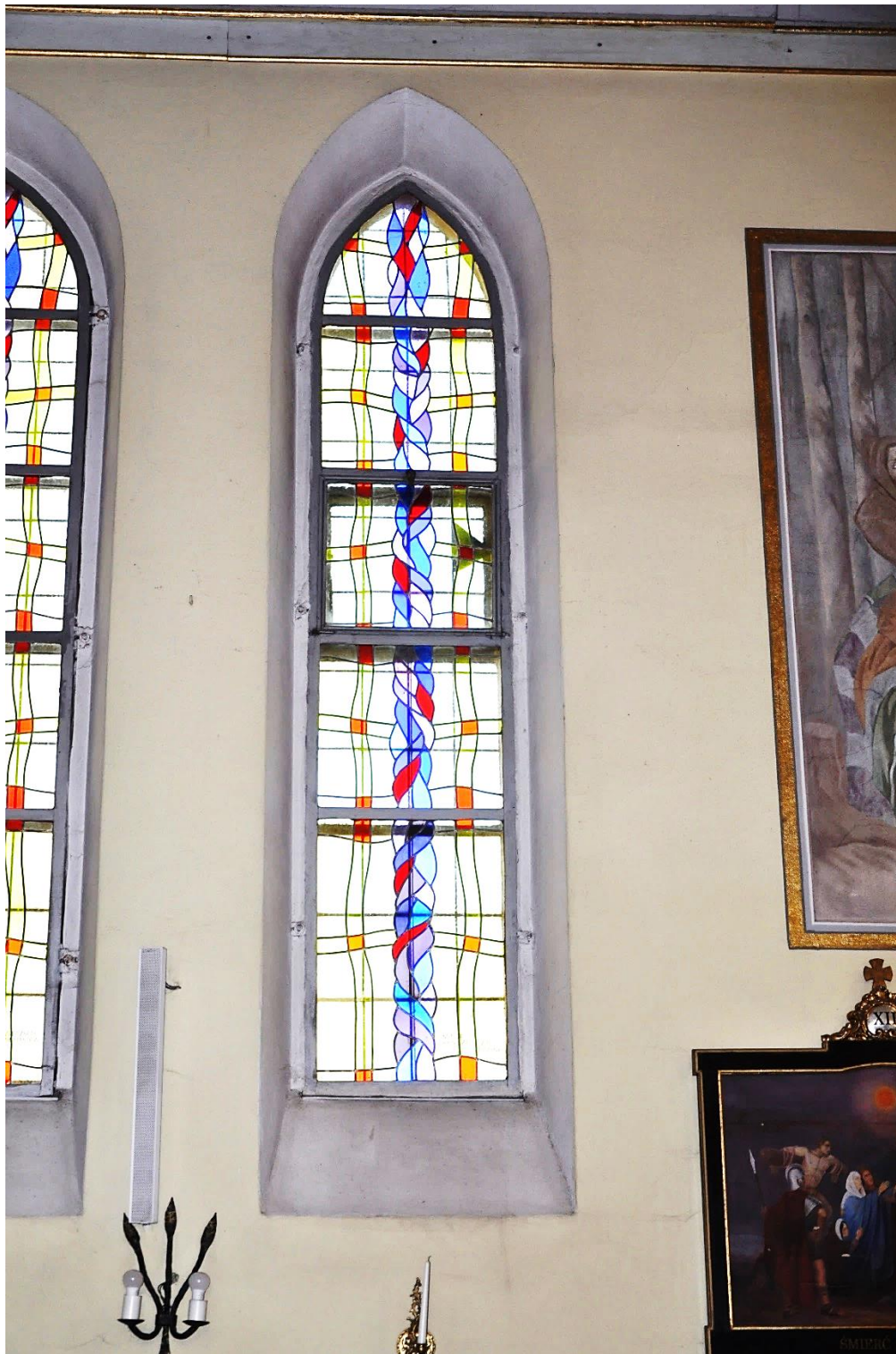
Fot. 21. Ściany uległy dużemu przybrudzeniu, co jest widoczne na pomalowanych na biało wnękach okiennych.
